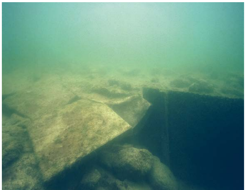
Abb. 42 Cham-Eslen. Schadensbild 2007: Die Gartenbetonplatten sind teilweise verkippt und fixieren das Geotextil (Bildmitte) nicht mehr.
