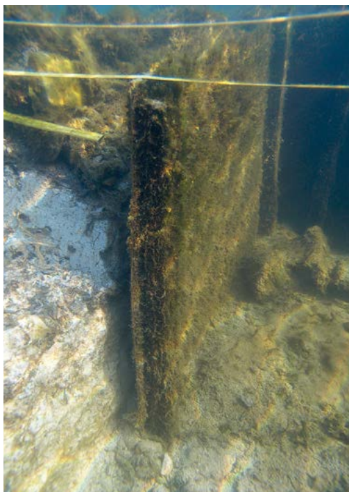
Abb. 40 Cham-Eslen. Schadensbild 2005: hinterspülter Profilschutz.
