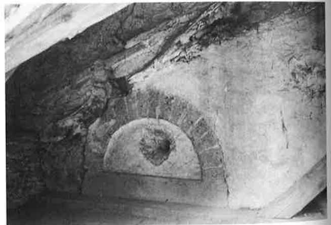
Abb. 203: Stein am Rhein. Stadtkirche. Alte Dachlinien und Tympanon der Türe zum Turmobergeschoss im Dachraum des südl. Seitenschiffes (vgl. Abb. 208).
