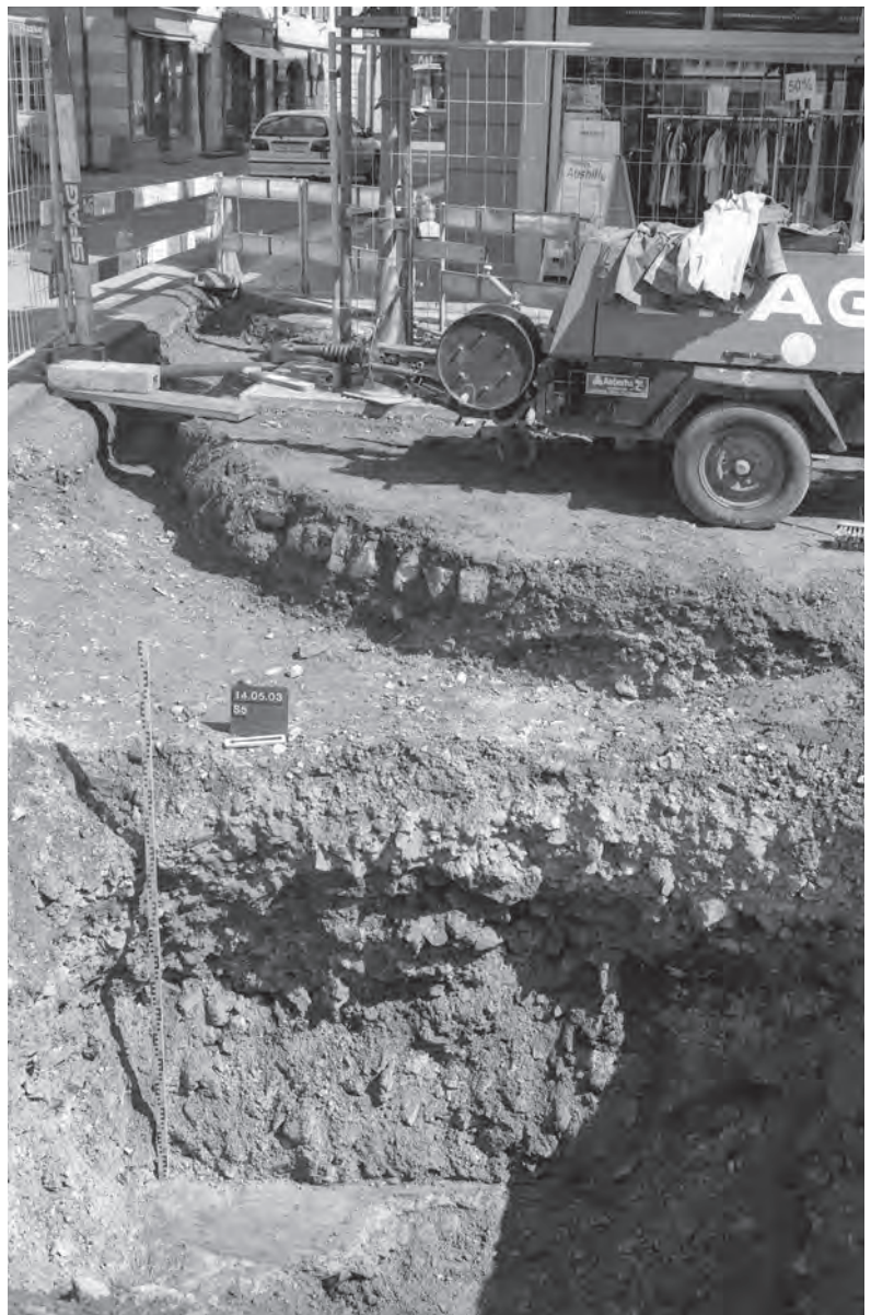
Abb. 45 Stans Dorfplatz 2003. Sondierung S5. Schuttschichten über dem Rest eines durchschlagenen Mörtelbodens. Dahinter, in der Wand des Grabens G6, ist eine alte Platzpflasterung angeschnitten. Von Nordwesten.
