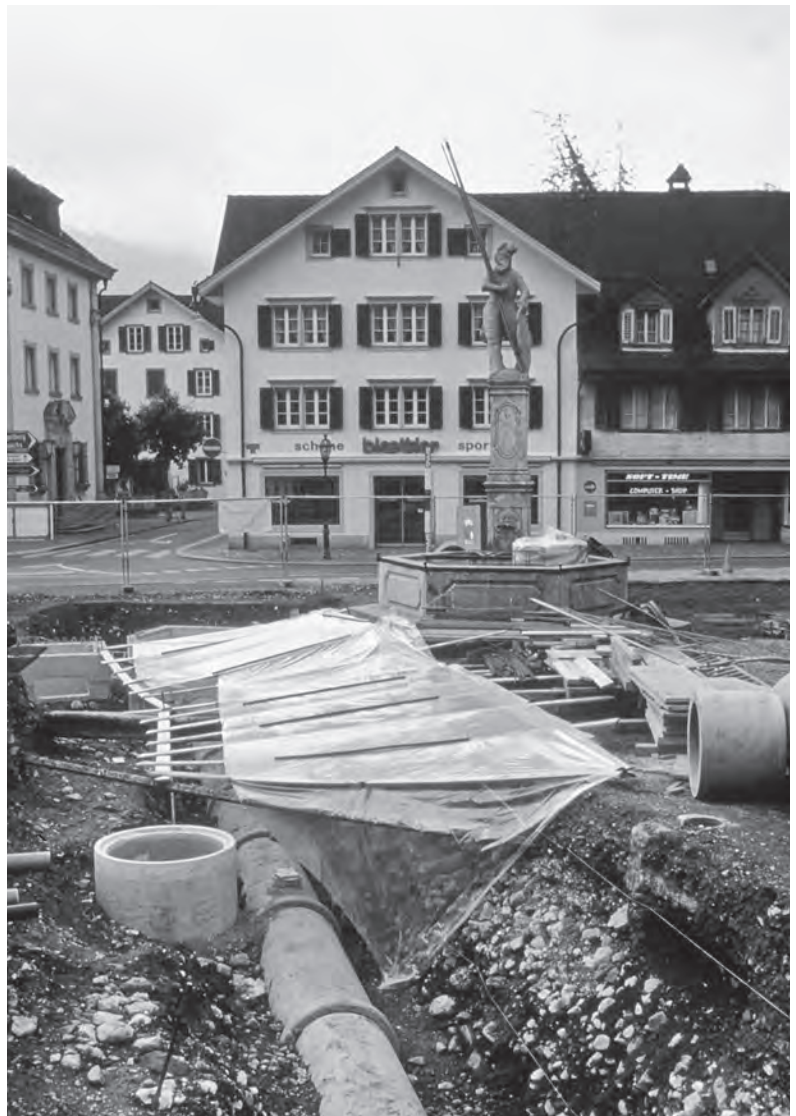
Abb. 4 ■ Stans Dorfplatz 2003. Improvisiertes Regenschutzdach über dem Graben G1 vor dem 1723 aufgestellten Winkelriedbrunnen. Von Südwesten.
